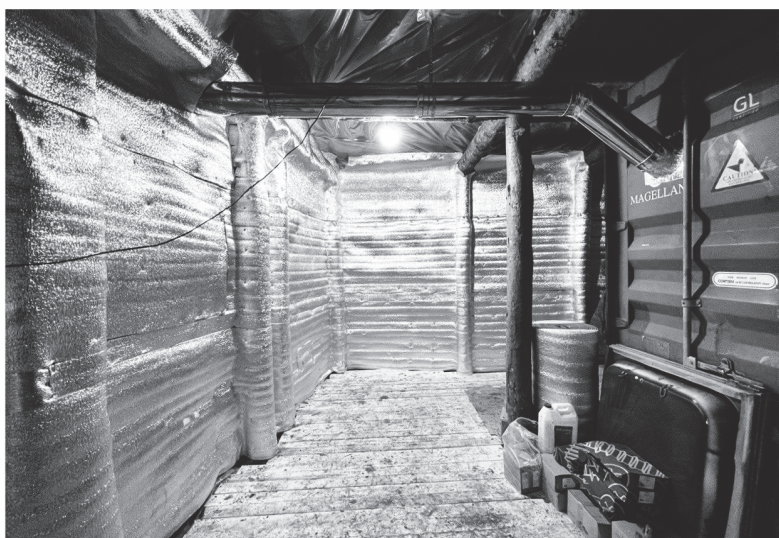
Так сейчас выглядят стены подземного ФАПа
